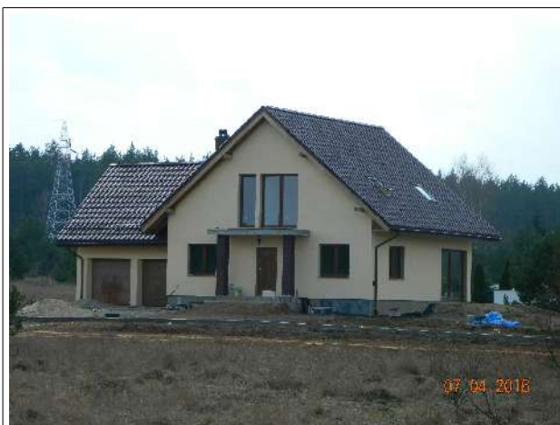
Budynek mieszkalny jednorodzinny w trakcie budowy, zlokalizowany na dz. nr 3700/2, ul. Baranki
