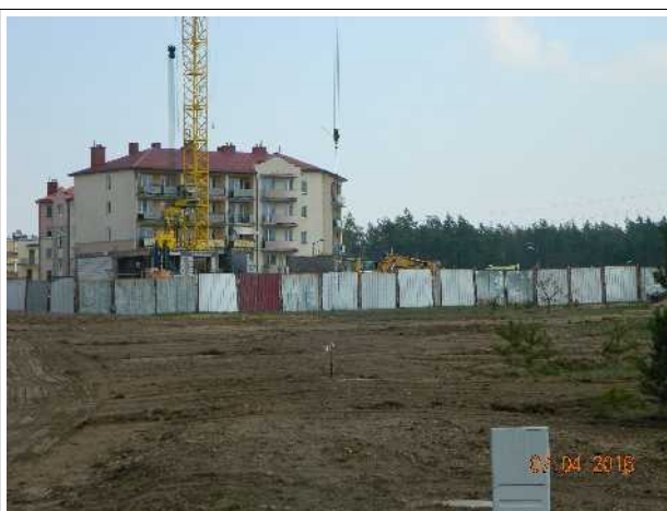
Teren budowy (zabudowa mieszkaniowa wielorodzinna) zlokalizowany na dz. nr 3902/19, ul. św. MM. Kolbe
