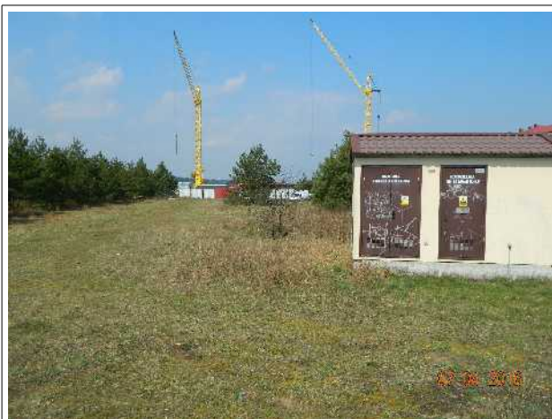
Stacja trafo zlokalizowana na dz. nr 3909, ul. Baranki
