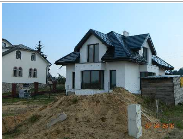
Budynek mieszkalny jednorodzinny w trakcie budowy, zlokalizowany na dz. nr 3899/4, ul. Spacerowa
