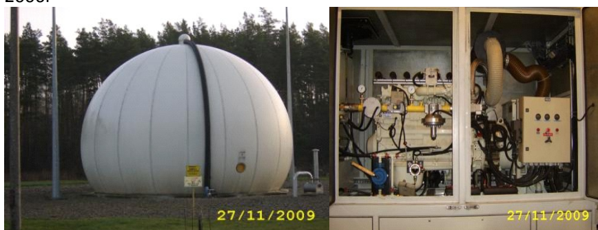
Zdj. 4 i 5. Instalacja do energetycznego wykorzystania biogazu z oczyszczalni ścieków PWiK w Etku
