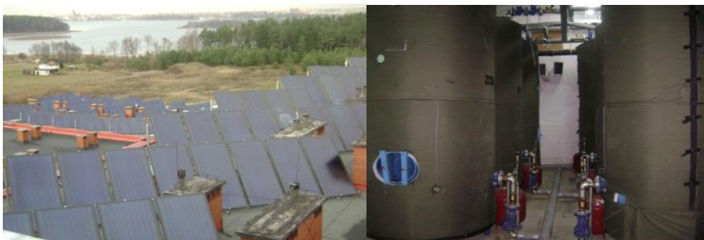
Zdj. 2 i 3. Instalacja solarna w Zakładzie Opieki Zdrowotnej „PRO-MEDICA”
