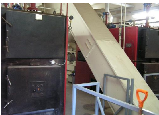
Zdj. 8. Kotłownia na biomasę w Zespole Szkół nr 1 (Źródło zdjęć i informacji: Starostwo Powiatowe w Ełku)
