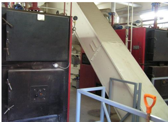
Zdj. 8. Kotłownia na biomase w Zespole Szkół nr 1 (Źródło zdjęć i informacji: Starostwo Powiatowe w Ełku)
