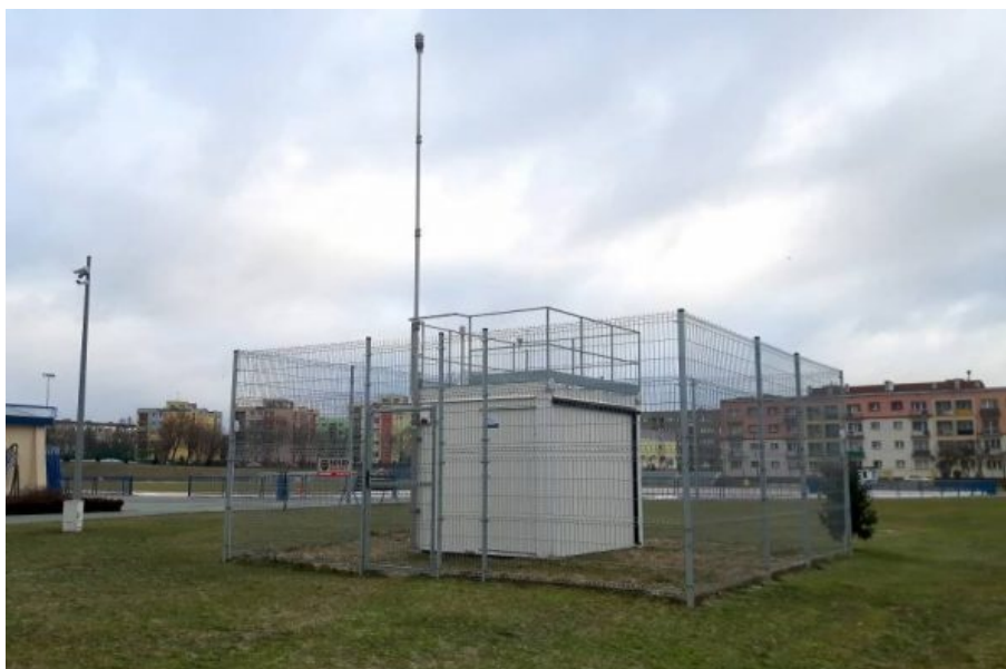
Ryc. 39. Automatyczna stacja pomiarowa jakości powietrza w Ełku
