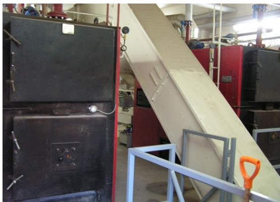
Zdj. 8. Kotłownia na biomasę w Zespole Szkół nr 1 (Źródło zdjęć i informacji: Starostwo Powiatowe w Ełku)
